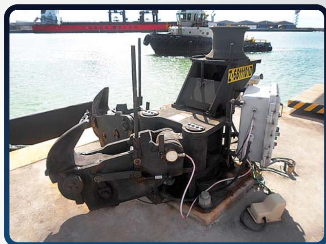
Transpetro –TABR – Barra do Riacho– RJ Capacidade: 80 tons
