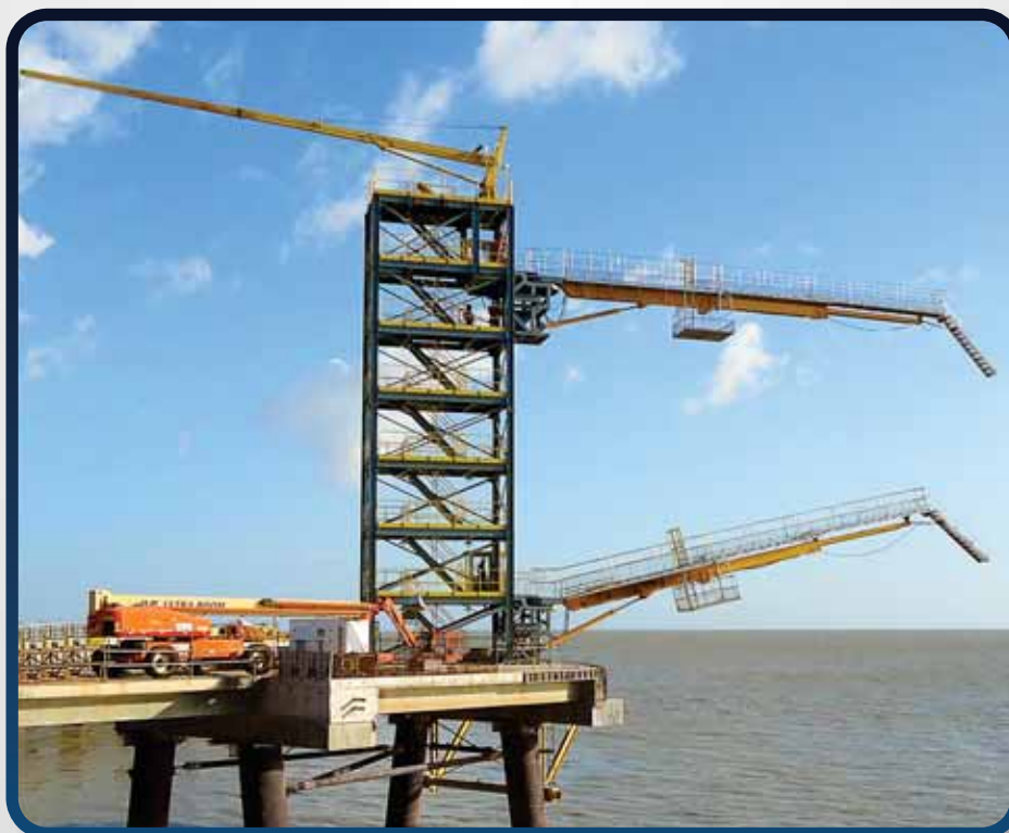
VALE S.A - SÃO LUÍS - MA - ALTURA DA TORRE: 18 m - 02 PASSARELAS TELESCÓPICAS - ALCANCE DA PASSARELA: 20 m - CAPACIDADE DO GUINDASTE: 500 KGF @ 20 m
