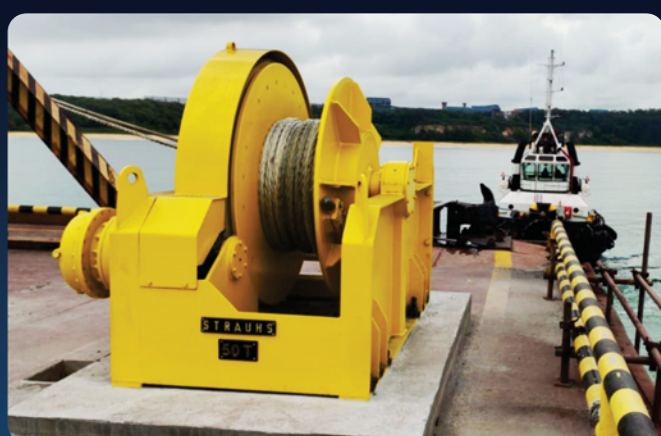
GUINCHO DE ATRACAÇÃO 50 TONS TESTE DE FRENAGEM COM REBOCADOR
